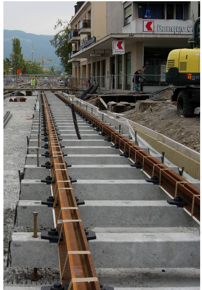
LIGNE 15 – Place du 1 er Août (traverses monoblocs)
